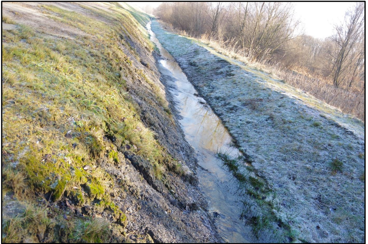
Fot. 12. Uszkodzone skarpy rowu, podatne na erozję.
